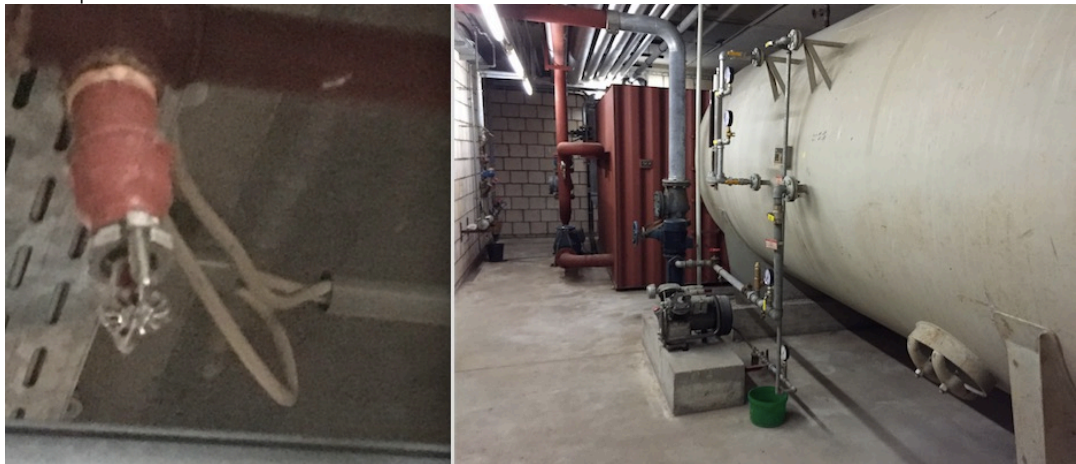
Sprinklerzentrale und Sprinklerkopf
